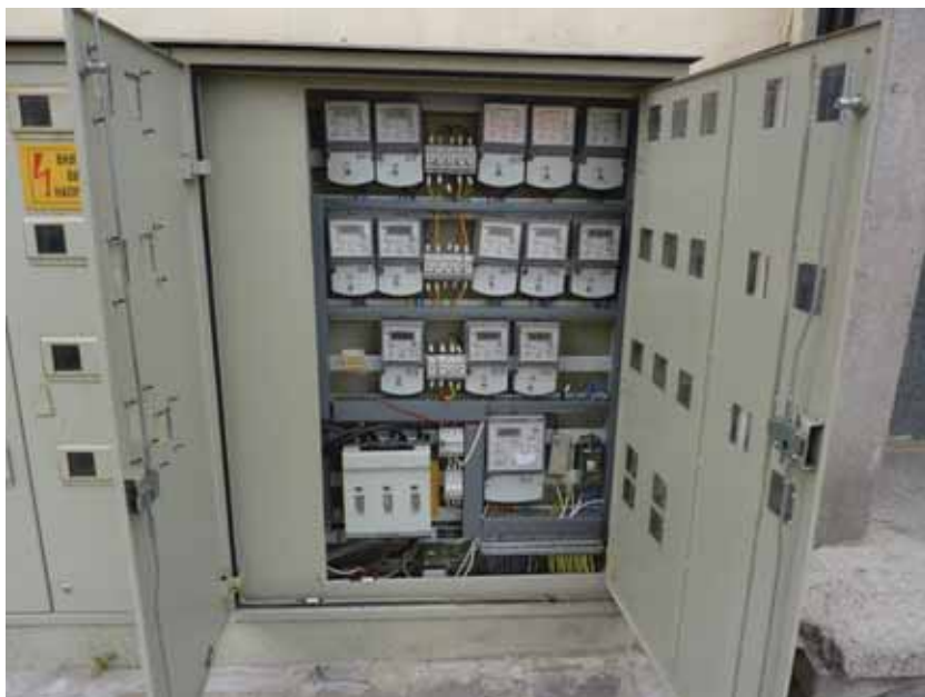
Електромерно табло на фасадата на жилищен блок в Столипиново след проекта на EVN България
