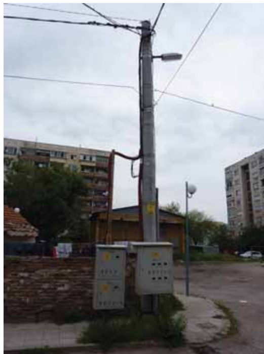
Електромерно табло на стълб и на пилон. Изолирана мрежа
